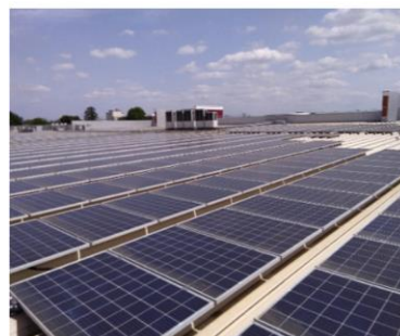
太陽光パネル
