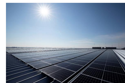
屋上太陽光パネル
