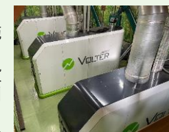
小型木質バイオマス熱電併給設備
