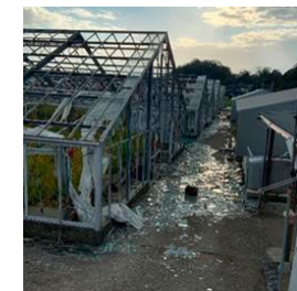
被災したガラスハウス (令和元年房総半島台風に伴う大雨)
