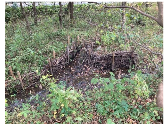
写真の説明：水路を浚渫し、剪定枝による粗朶柵工で、泥土の流入を抑制
