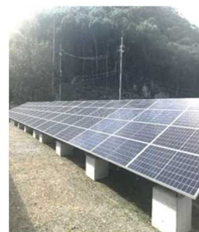
設置した太陽光パネル
