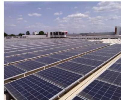
太陽光パネル
