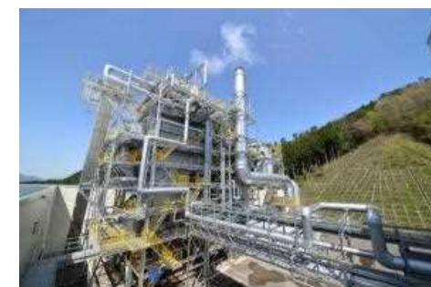
真庭バイオマス発電所
