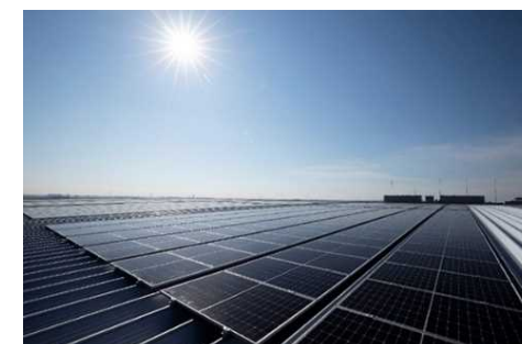
屋上太陽光パネル
