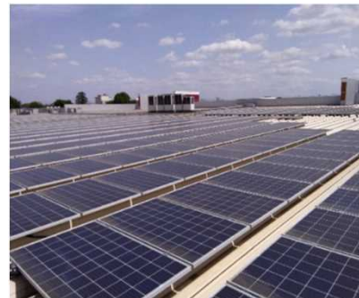
太陽光パネル
