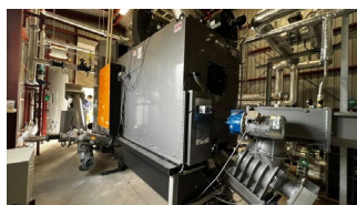
バイオマス（チップ）ボイラ
