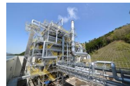
真庭バイオマス発電所
